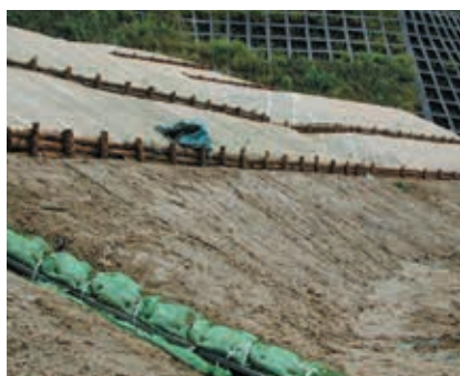
施工前(流下水により侵食がすすんでいる)
